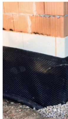
Bei der Erstellung des Kostenvoranschlages nicht auf die Isolierung der Fundamente vergessen.
